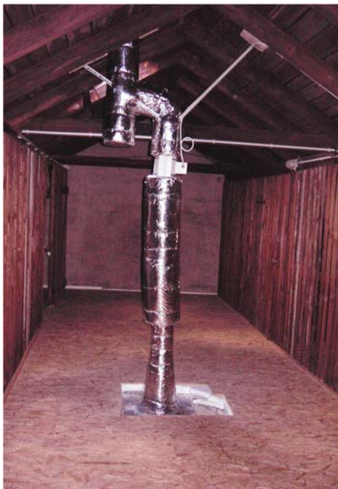
eingebaute Lüfteranlage mit Kondenzwasserfalle im Dachboden des Gebäudes
