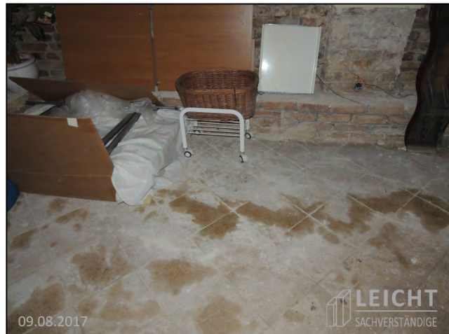
Abb. 5: Feuchtflecken auf einem Kellerbodenbelag
