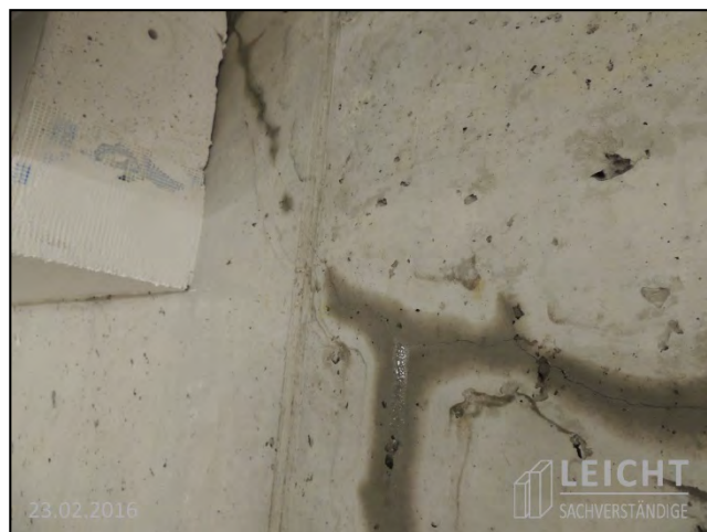
Abb. 3: wasserführender Riss in WU-Konstruktion
