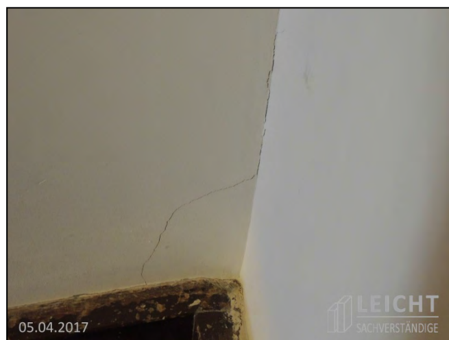
Abb. 2: Setzungsrisse infolge Unterfangungsarbeiten
