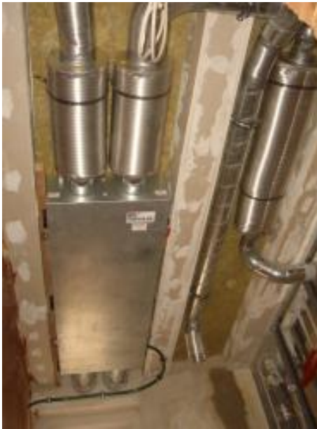
Abb. 1 Zentrales Luftgerät mit Wärmerückgewinnung
